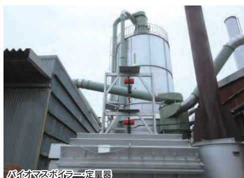
バイオマスボイラー・定量器
